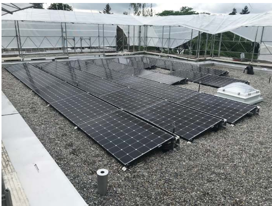
Ansicht der Solarpanel auf dem Dach des Pfarrhauses Zollikerberg
